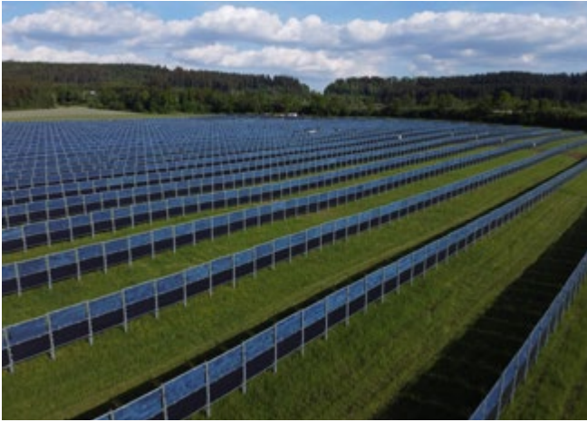
Abbildung 9: APV-Pilotanlage in Donaueschingen
